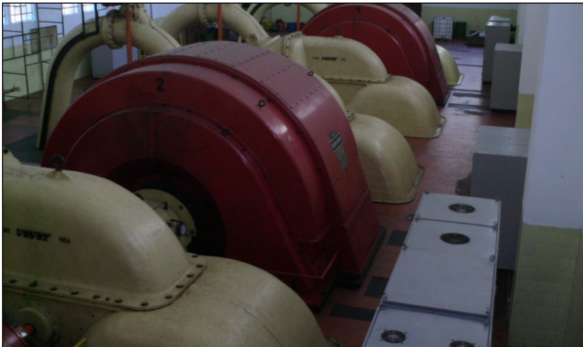
Figura 2 – Turbinas da Usina Hidrelétrica dos Bugres em Canela - RS
