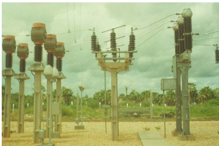
Figura 14 Detalhe de Chave Seccionadora de uma SE de 69 kV
