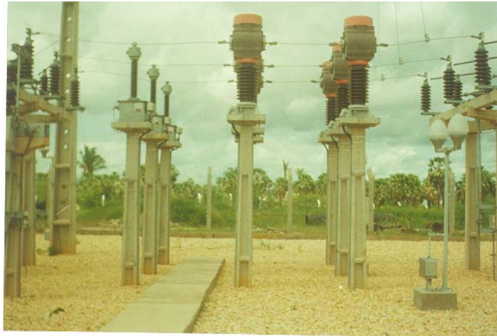
Figura 12 Detalhe de TI's de SE de 69 kV
