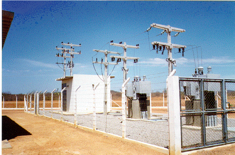
Figura 4 Vista Geral de SE de 13,8 kV Ao Tempo
