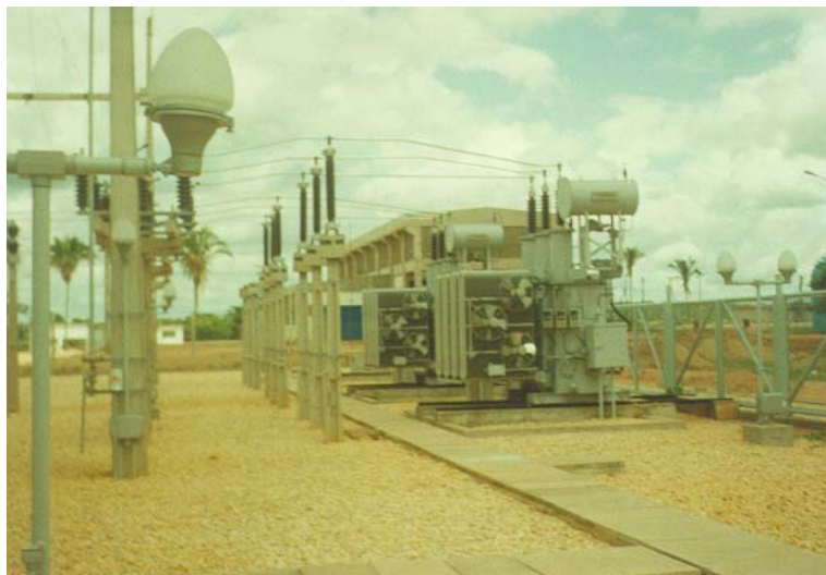
Figura 13 Detalhe de um Transformador de uma SE de 69 kV
