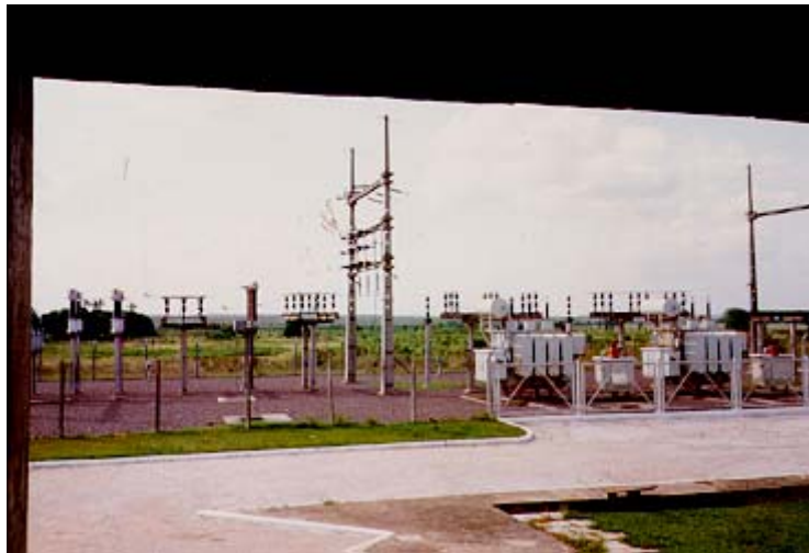
Figura 10 Visão Geral: SE 15 MVA – 69 / 4,16 kV
