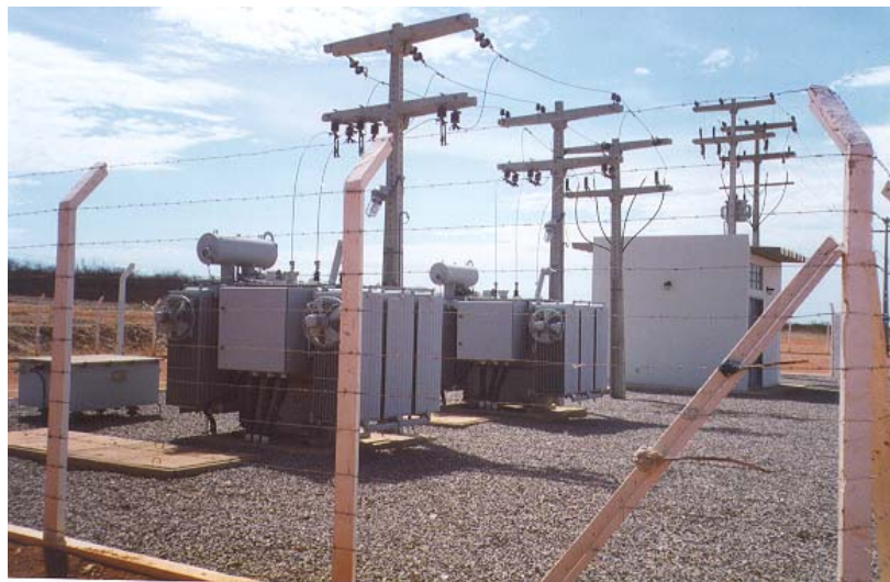
Figura 5 Detalhe do Transformador: SE de 13,8 kV Ao Tempo
