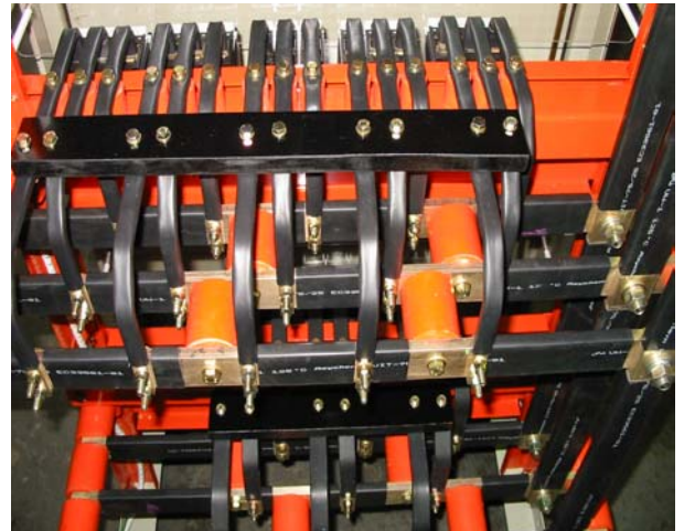
Figura 22– Montagem com barragem isolados com termo-retrátil, identificados por disposição.
