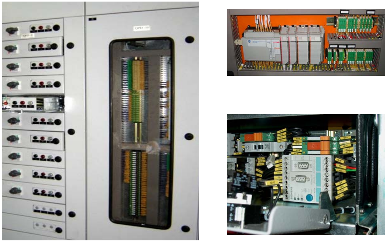
Figura 16 – Vista interna de uma gaveta com escravo para rede AS-I e instalações com CLP.
