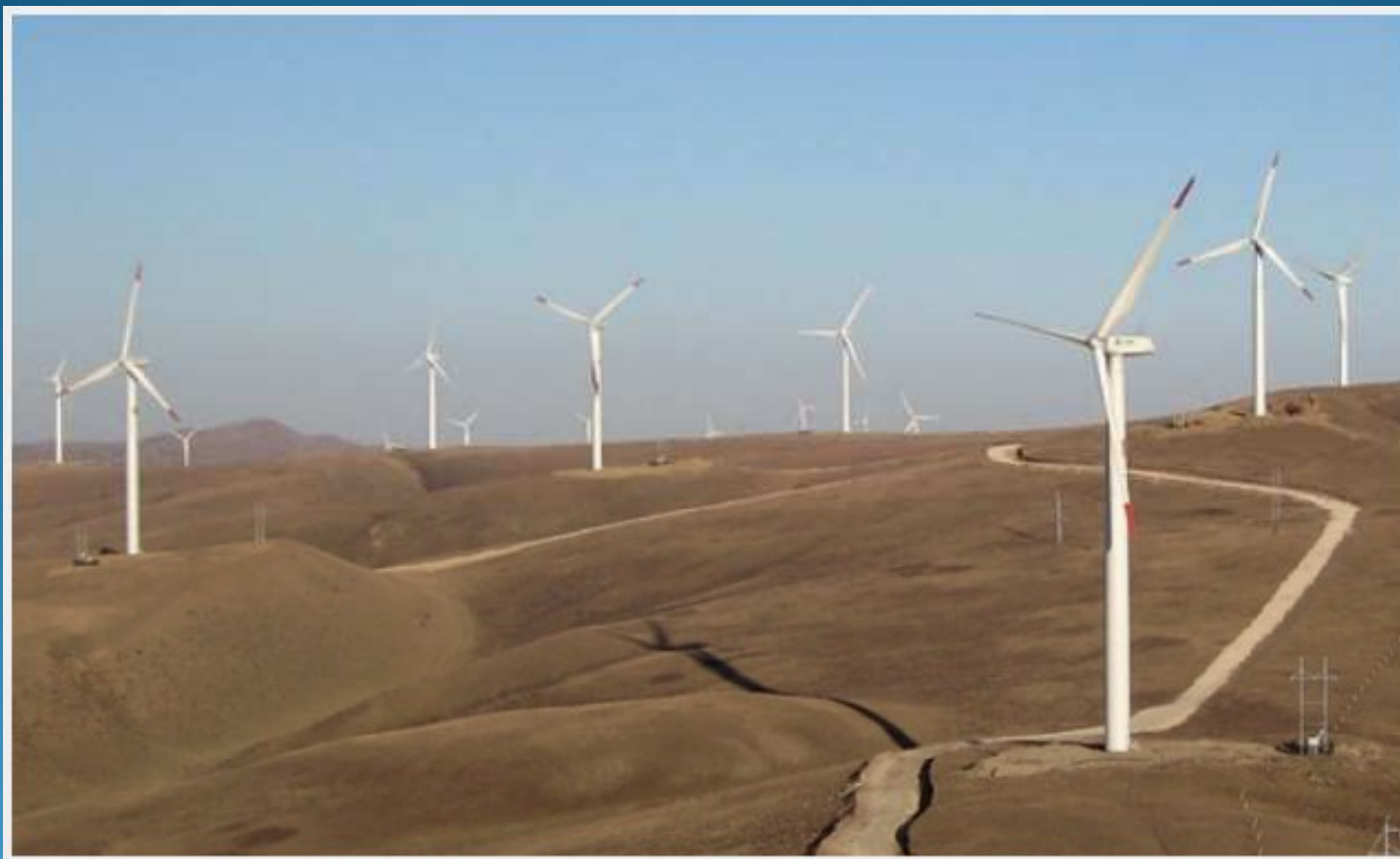
Figura 3 – Parque Eólico em terra – Instalação On-Shore – Situação majoritária no Brasil
