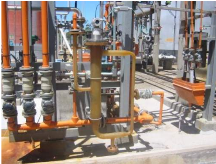
Instalação medindo ácido clorídrico
