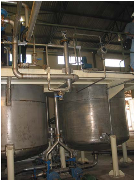
Tanque de fluxo dividido instalado após a bomba de processo
