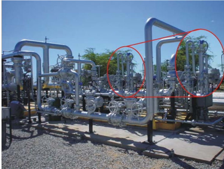
Skid de medição fiscal
